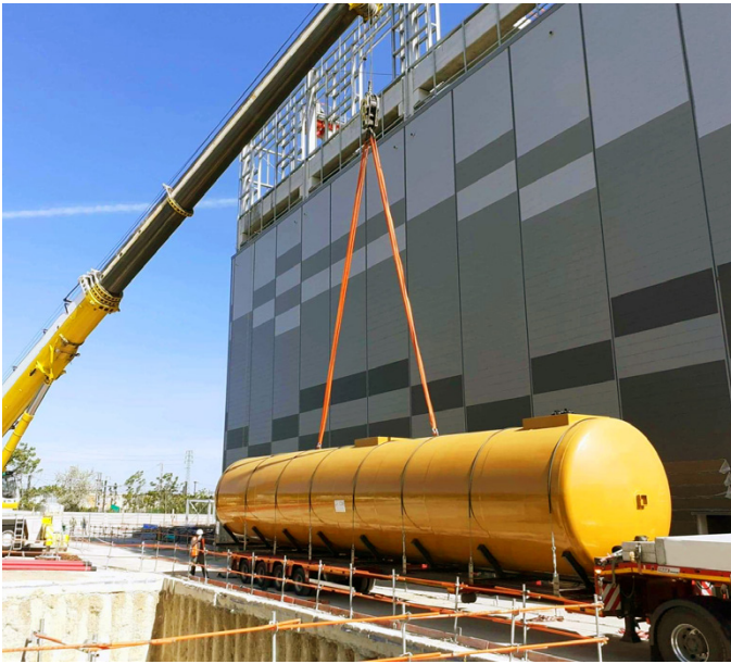
Este Centro de Datos requería un sistema de tuberías de alto rendimiento que permitiera un caudal de 933 litros / minuto
