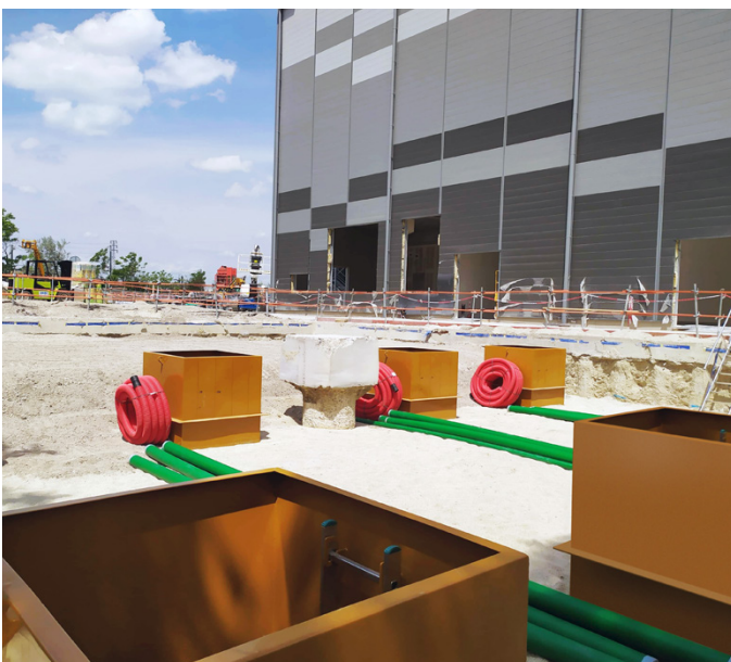
La tubería conductiva de doble pared KPS de 2" (75/63 mm) conecta los tanques de combustible con los generadores de respaldo
