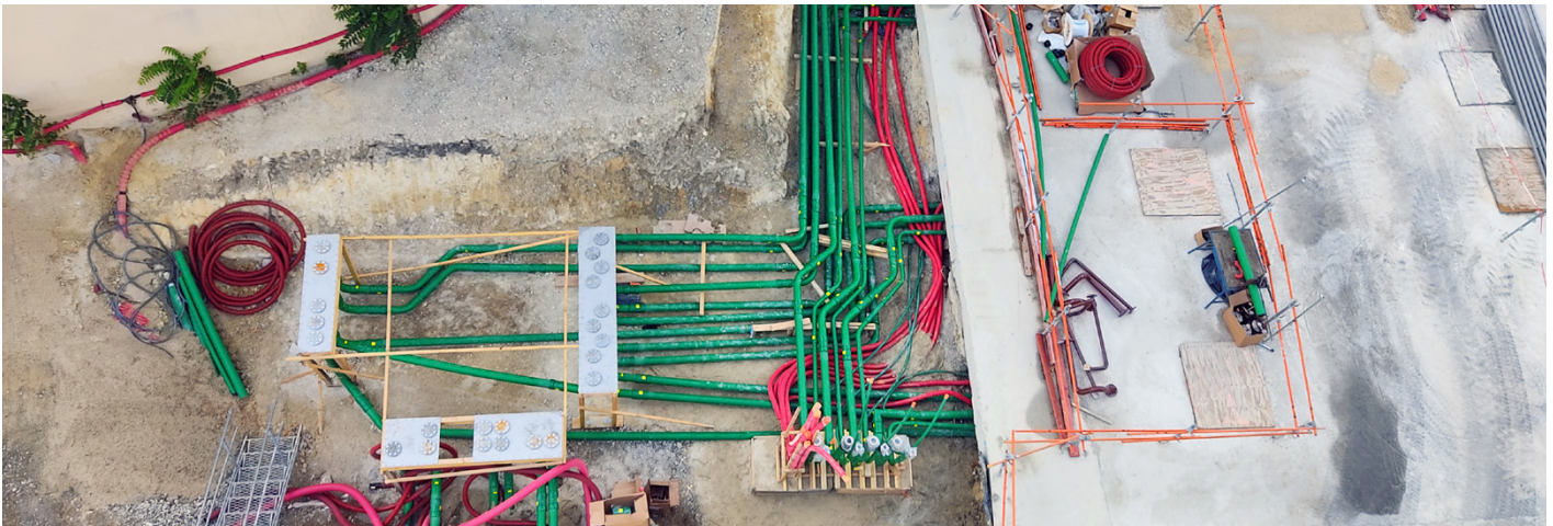
En la nueva instalación de centro de datos en París (Francia), se especifica tuberías de doble pared KPS para el suministro de diésel de sus generadores de respaldo
