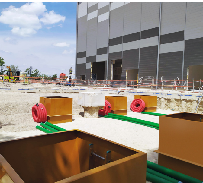
KPS 2" (75/63mm) iletken çift cidarlı borular, yakıt depolarını yedek jeneratörlere bağlamak için kullanıldı.
