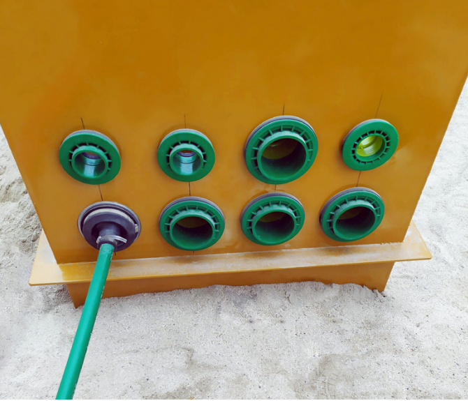
Sıvı geçirmez KPS boru giriş contaları, yakıt kaçağına ve yeraltı suyu girişine karşı tam koruma sağlar.
