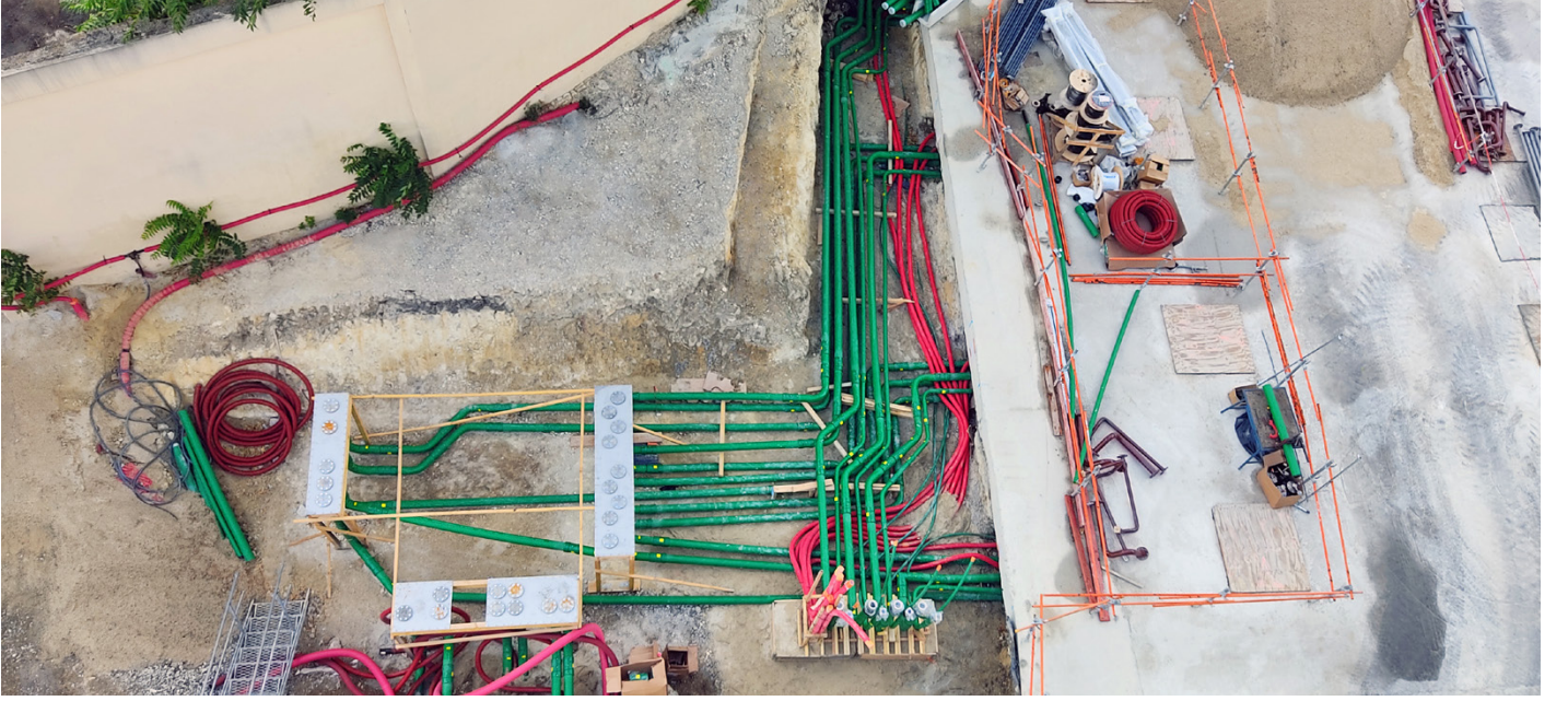
Fransa, Paris'teki yeni bir veri merkezi tesisi, sistem jeneratörlerine yakıt sağlamak için KPS çift cidarlı borularını seçti
