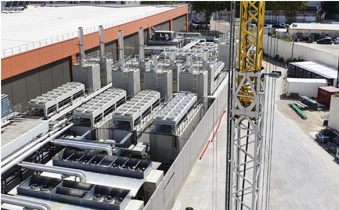
Veri merkezleri, kesintisiz bir güç kaynağı sağlamak için bir dizi yedek jeneratöre ihtiyaç duyarlar.
