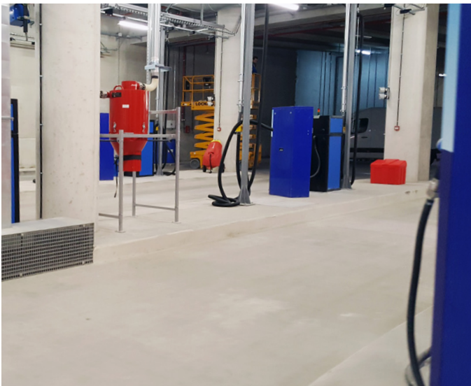
Debido a que los puntos de repostaje se instalaron dentro de un garaje, un sistema de tuberías con permeabilidad cero y libre de fugas era esencial.
