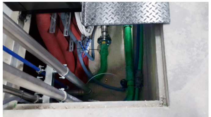
La tubería KPS proporciona es caudal de combustible de 933 litros / minuto necesario para suministrar diésel a la flota de autobuses
